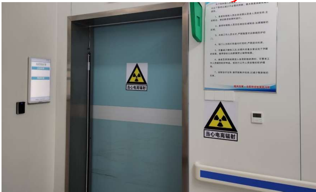
机房门防夹装置、电离辐射警告标志
