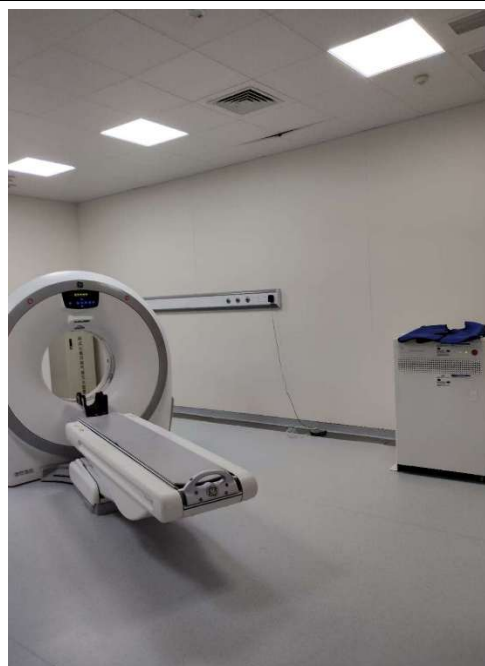
机房西侧 CT 室
